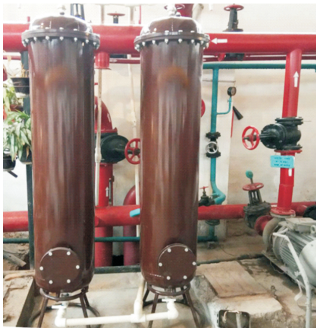
Рис. 5. Система химводоподготовки с применением нанокompозитного катионита, установленная в мини-котельной, эксплуатируемой ГУП «Toshissiqquvvati» в Мирзо-Улугбекском районе г. Ташкент
